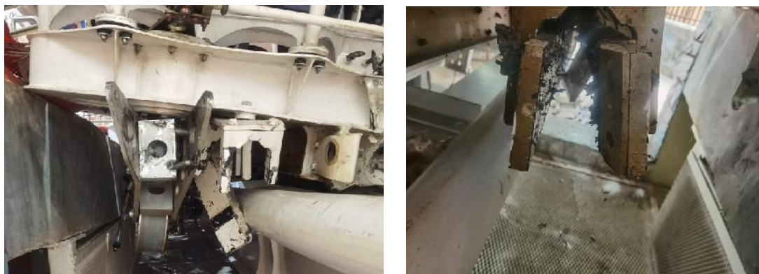
图 7 1 号车车体底部永磁体损坏情况
